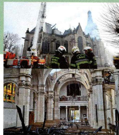
Destruction de la charpente par l'incendie
